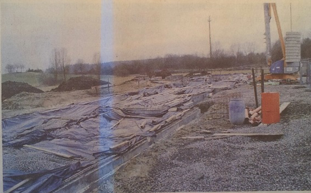
In der Salinenstraße ist eine sechsgruppige Kindertagesstätte im Bau, die Betonfundamente sind gegossen, der Baugrund ist noch zum Schutz vor Regen abgedeckt. Foto: Hans-Jürgen Eisenmann
