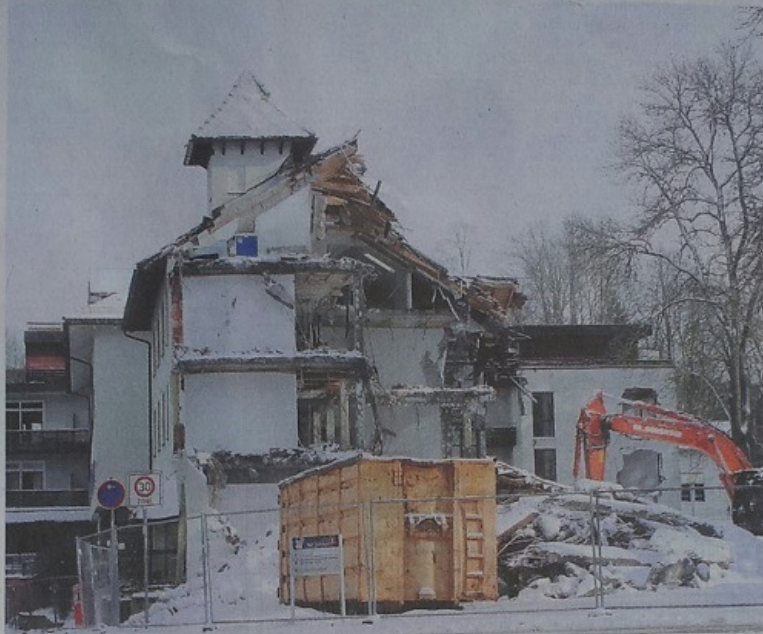
Vom Abribsbagger halb angenagt: die ehemalige Klinik Irma. Aus Verärgerung ließ Investor Casim Ucucu die Arbeiten gestern einstellen, der Bagger wird abgezogen.
