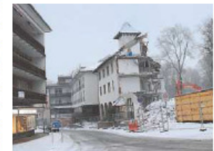
In der Hofstraße (oben) verläuft die Musel unter der „Irma“. Mitte: Besprechung beim Ortstermin mit Investor (Dritter von links) und Planer, unten: der Abriss wird gestoppt. Fotos: Eisenmann
