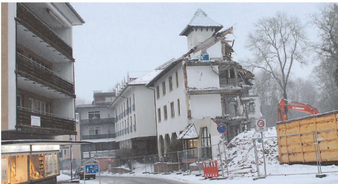
Die Abrissruine Irma an der Ecke Luise- und Hofstraße, links das Haus Friedrichstraße 1 und Blick in die Hofstraße, unter der die Stille Musel hindurch in Richtung Irma-Areal durchfließt. Foto: H.-J. Eisenmann
