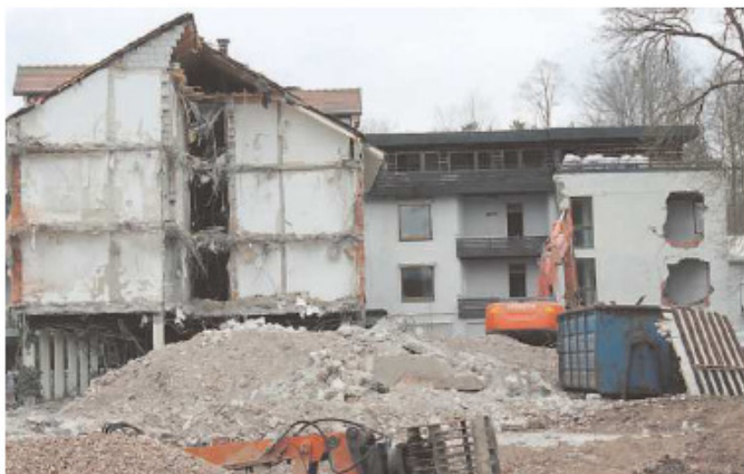
Der Abriss der ehemaligen Klinik Irma geht planmäßig weiter, er soll Ende Mai abgeschlossen sein.
