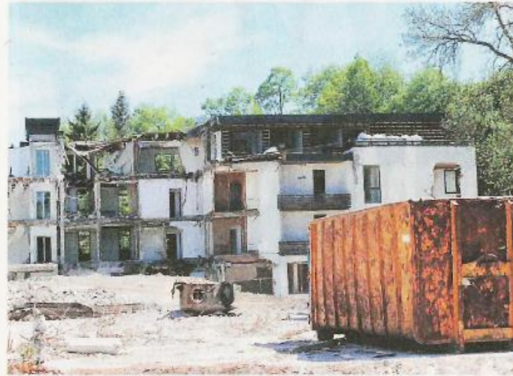
Seit Wochen tut sich auf der Abrissbaustelle mitten in der Stadt an der Luisenstraße nichts mehr. Foto: Hans-Jürgen Eisenmann
